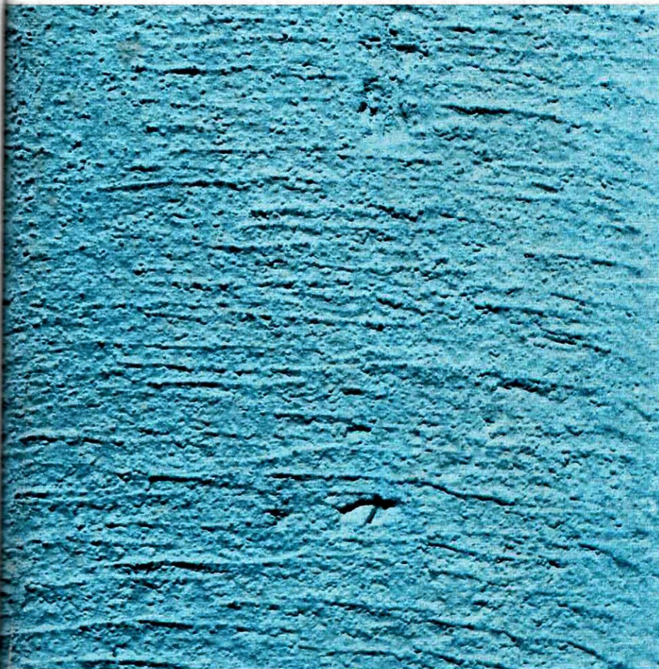
BÉTON A L'EAU DE MER TRAITÉ AU PROCÉDÉ « S » : PARFAITEMENT NET
