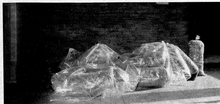
A Jussieu, le remède a été pire que le mal : pour débarrasser le plafond des couches d'amiante qui se désagrégeaient sous l'effet des courants d'air, on a gratté l'amiante à sec, ce qui est extrêmement dangereux. Il ne semble pas que les travaux d'enlèvement aient été effectués dans des conditions correctes de sécurité.
