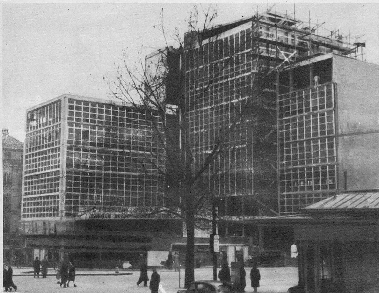
IMMEUBLE DE NEUF ÉTAGES CONSTRUIT ENTRE LE 7 JUILLET ET LE 3 SEPTEMBRE 1952, A GENÈVE.
