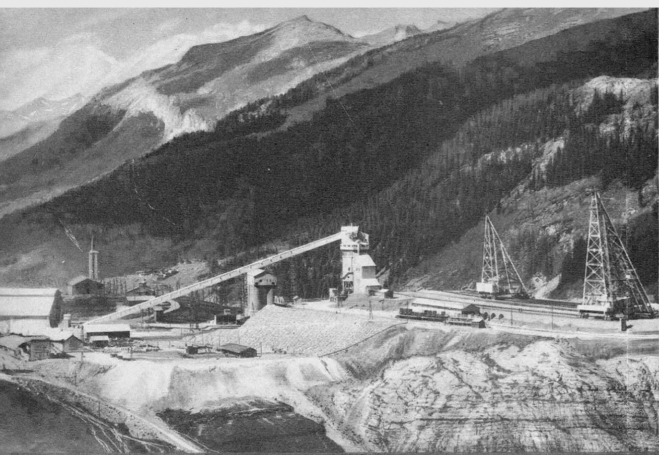
DE GAUCHE A DROITE : LES SILOS DE STOCKAGE DES AGRÉGATS, DU CIMENT ; L'USINE A BÉTON ET LES
