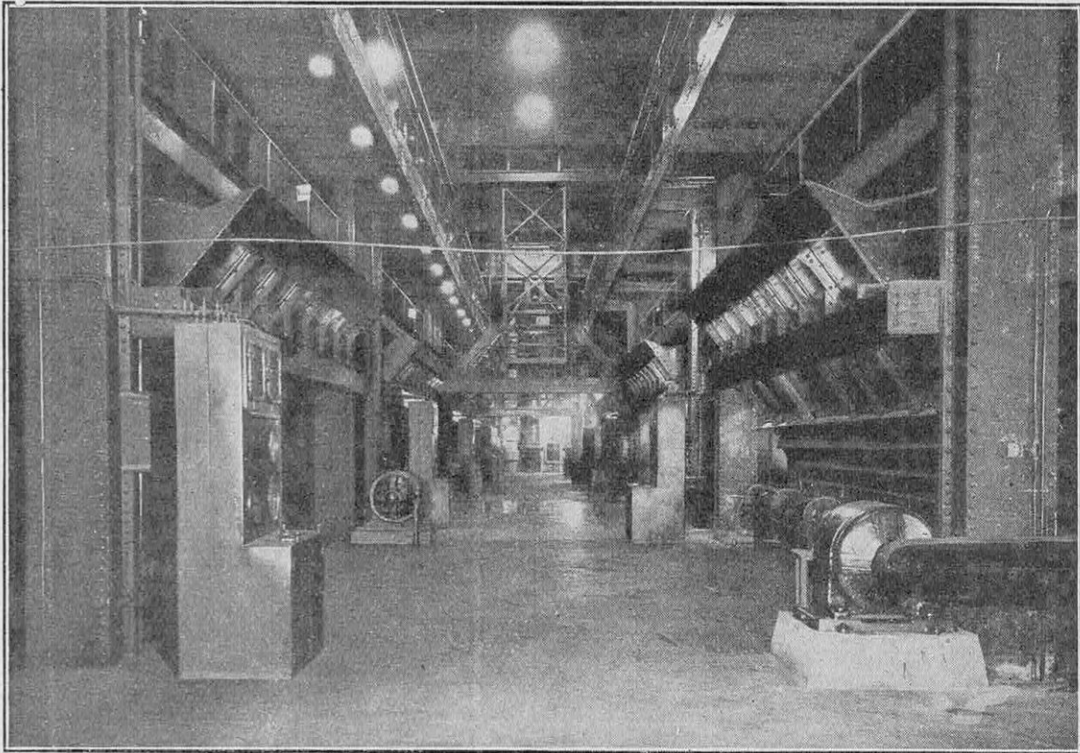
SALLE DES CHAUDIÈRES DE L'USINE DE LA HUDSON AVENUE, APPARTENANT A LA BROOKLYN EDISON COMPANY, A BROOKLYN.
