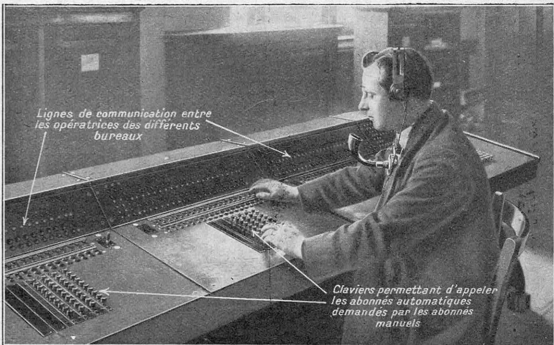
INSTALLATION SEMI-AUTOMATIQUE PROVISOIRE D'UN BUREAU AUTOMATIQUE
