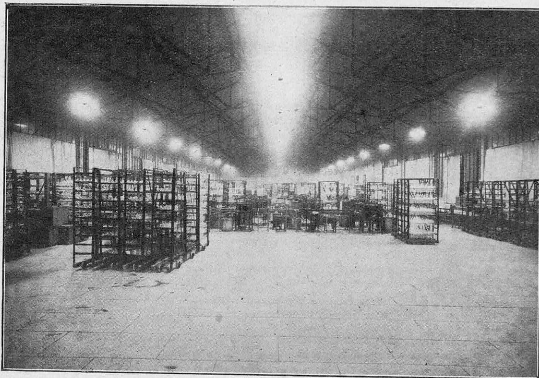
ÉCLAIRAGE GÉNÉRAL D'UN ATELIER AU MOYEN D'APPAREILS A RÉFLECTEURS
